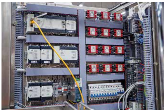
Шкаф управления системой струйной отмывки
